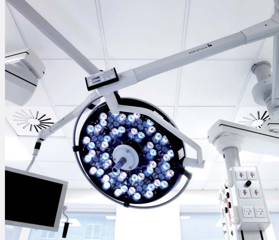
Operasjonsstue på Gentofte Hospital. Himling: Gyptone Base 31 – kant E
